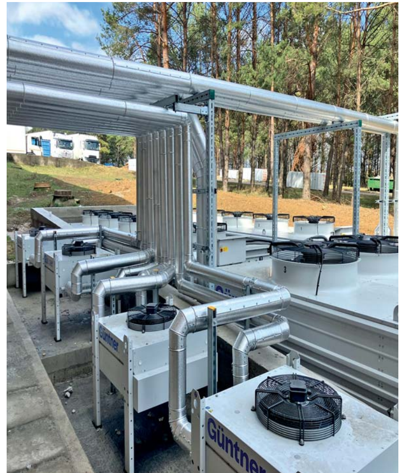
Vonkajšie jednotky kondenzátory – technológia mrazenia a chladenia.
