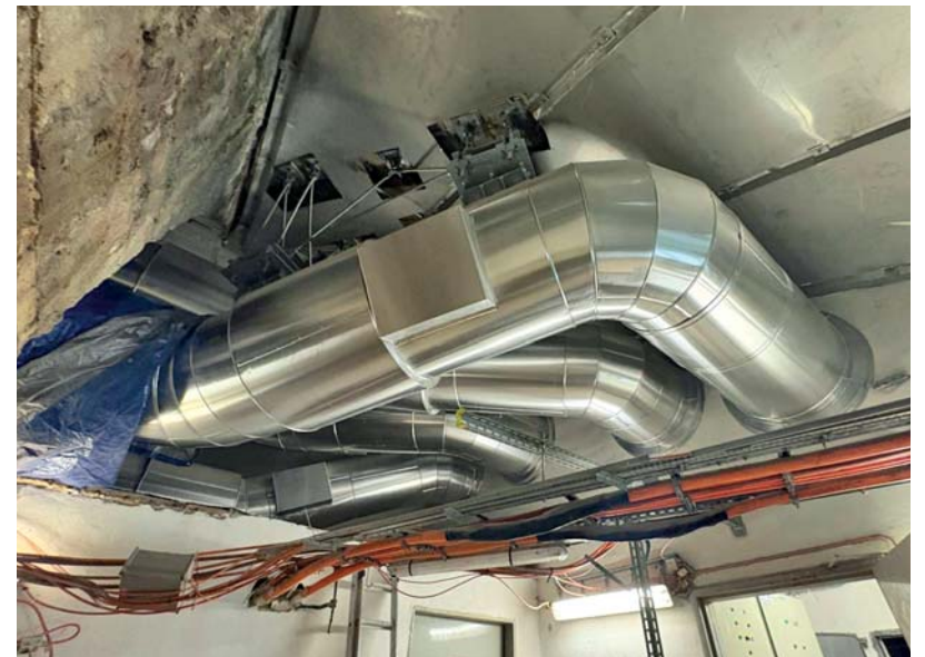
Vyvedení spalinovodu ze strojovny motorgenerátorů.
