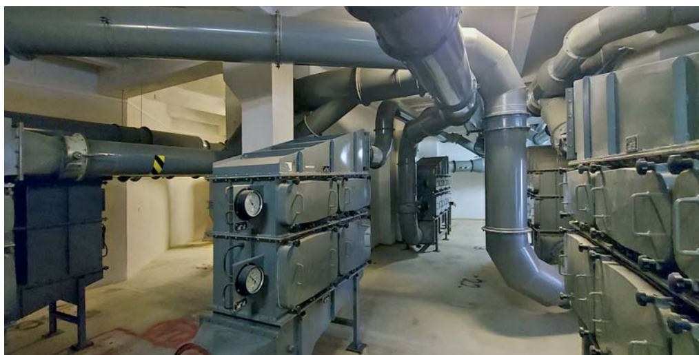
Filtrační jednotky před rekonstrukcí.
