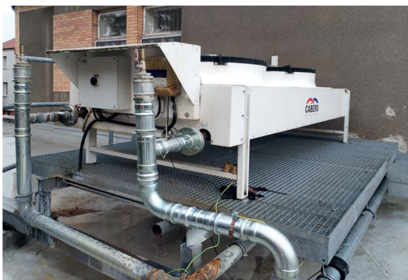
Suchý chladíč z Nemocnice Přerov, vyžadující servis.
