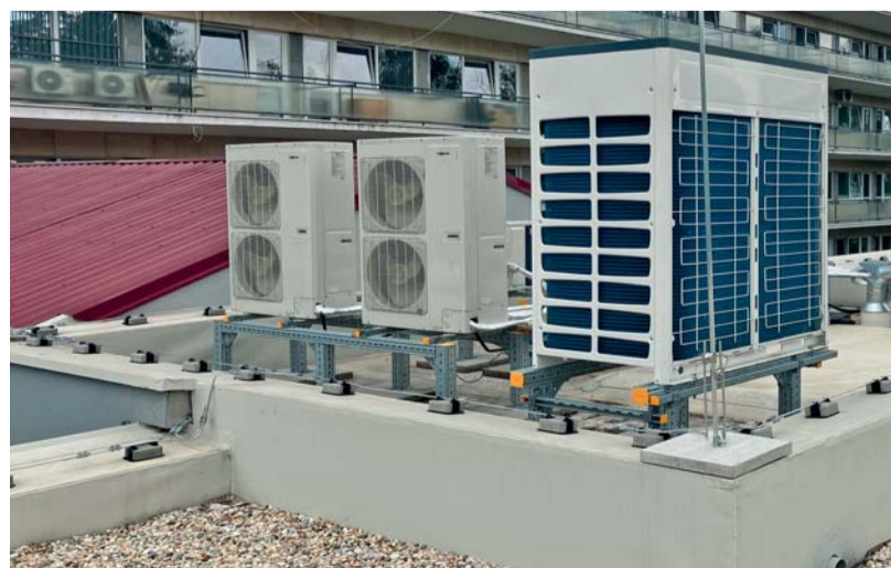
Pohľad na tepelné čerpadlá Viessmann a HAIER MRV systém
