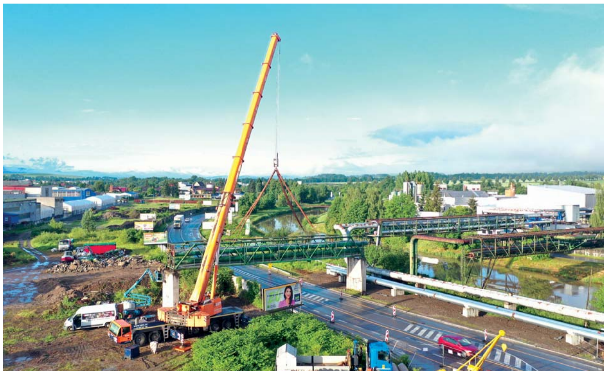
Demontáž 37 tonového potrubného mosta žeriavom o nosnosti 250 ton v Martine. Odkaz na video, QR kód, na strane č.5.
